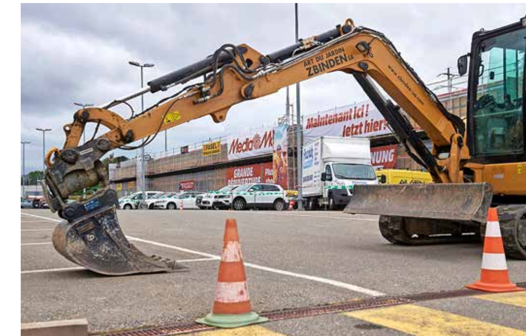
Die Fassade und der Parkplatz beim Einkaufszentrum St. Leonhard werden aufgefrischt. Bild Corinne Aeberhard
