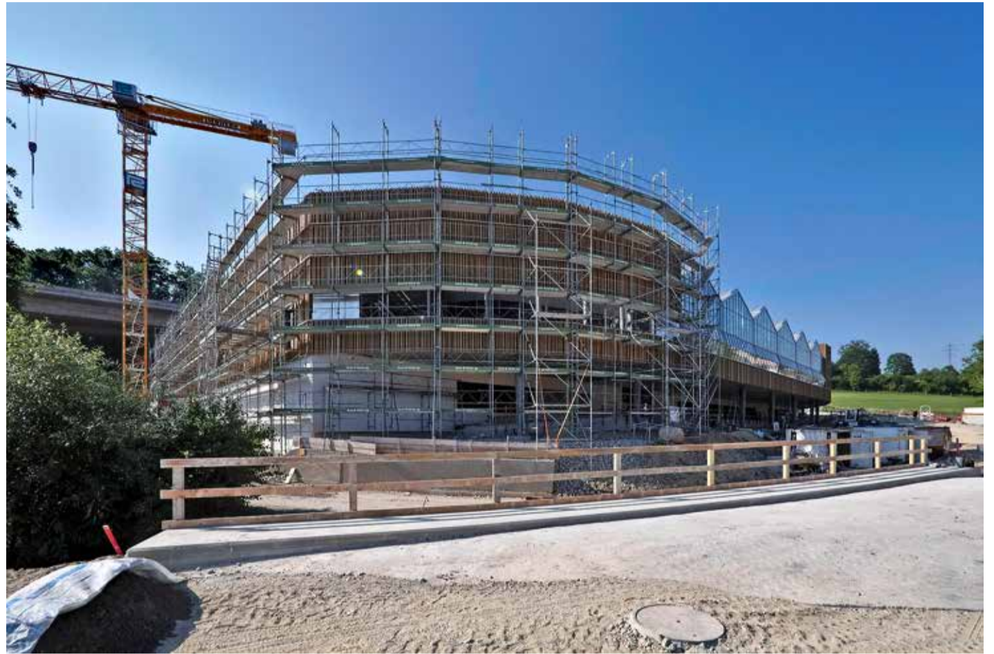
Das Ziel der Architekten war es, den Bau in den Hang unterhalb des Autobahnviadukts zu integrieren.
